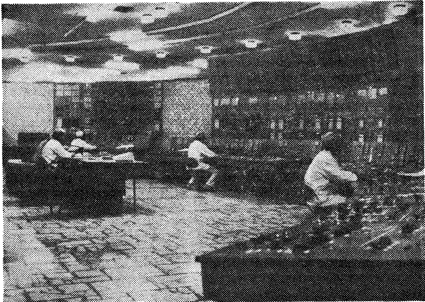
Рис. 6.36. Блочный щит управления АЭС
