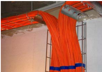
Рис. 4.159. Кутові прокладки, змонтовані на решічастих кабельних лотках
