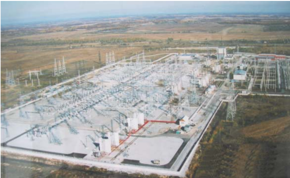
Рис. 4.123. Розподільний пристрій підстанції 500 кВ з повітряною ізоляцією
