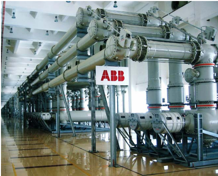
Рис. 4.127. Розподільний пристрій підстанції 550 кВ з елегазовою ізоляцією
