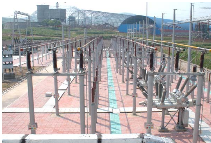
Рис. 4.126. Підстанція 110 кВ, побудована на базі комутаційних модулів системи PASS
