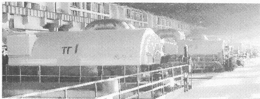
Рисунок 1.8 – Турбогенератори в машинному залі ТЕС
