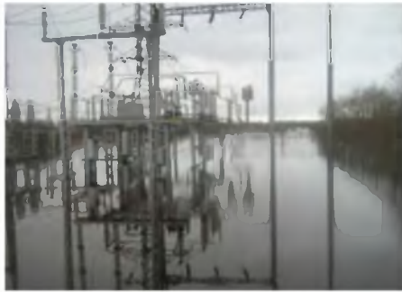
Рис. 4.7. Затоплена електрична підстанція
