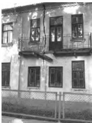
Рис. 4.8. Утворення тріщин на будівлі внаслідок просідання ґрунту (м. Житомир)
