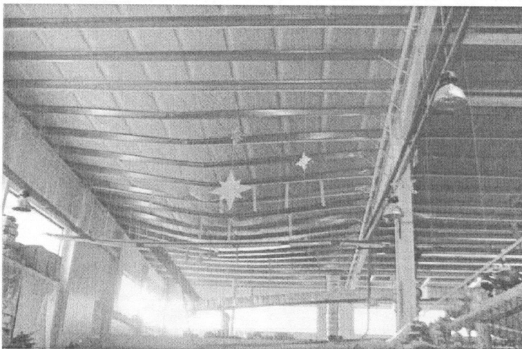
Рис.3.48. Деформування покриття в місці потужного снігового намету
