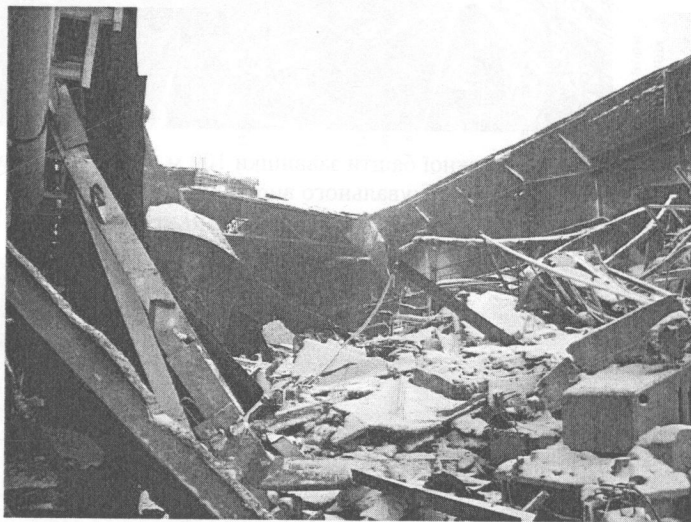
Фото 12. Обвалення покриття будівлі травильного відділення металургійного комбінату (2006 р.)
