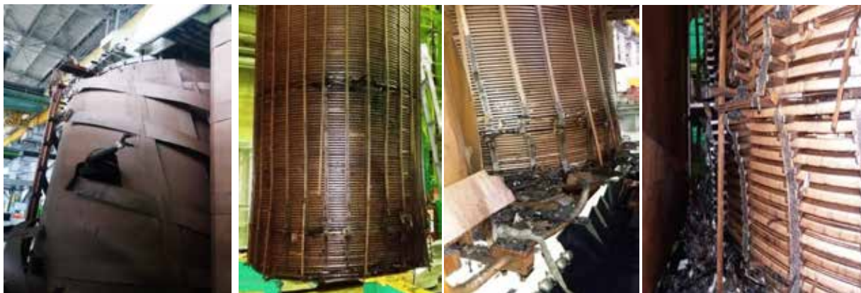
Рисунок 1 – Пошкоджений реактор 750 кВ.
