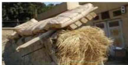
Рисунок 3 – Руйнація стіни А внаслідок нерівномірного навантаження [11]
