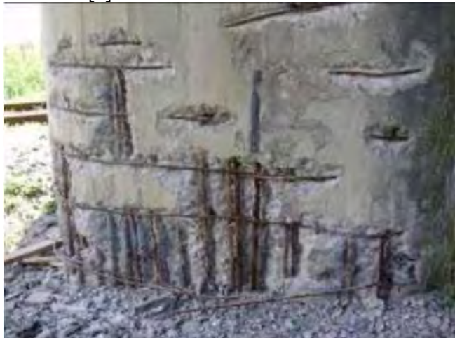
Рис. 1. Корозія залізобетонної конструкції
