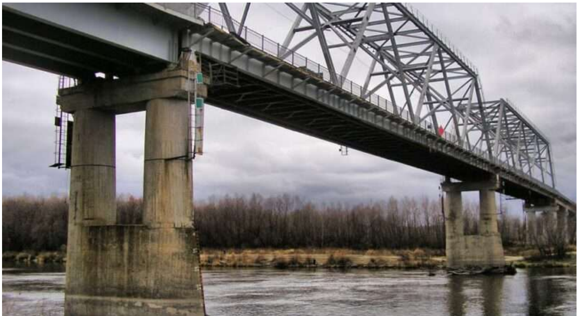
Рисунок 2.3 – Автомобільний міст через р. Десна у Чернігівській обласні із їздовим полотном в рівні нижнього поясу ферм і жорсткими опорами. Фотографія взята з джерела [12]
