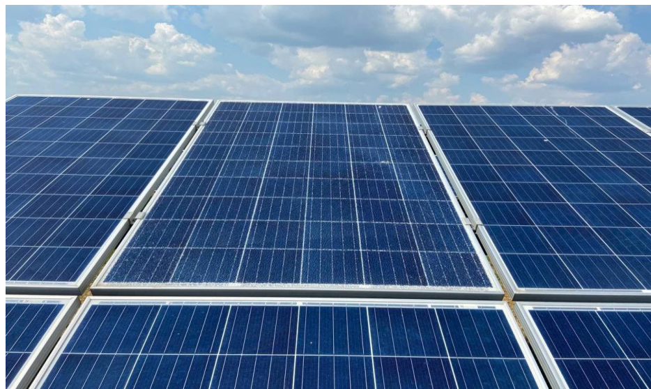
Рисунок 4.6 – Механічне пошкодження ФЕМ
