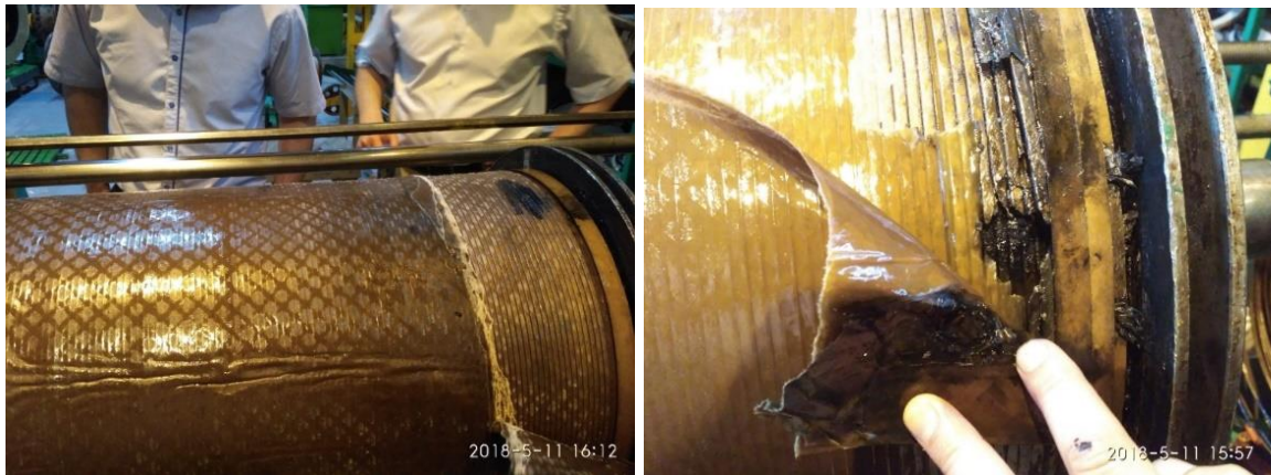
Рисунок 4.20 – Пошкодження обмоток трансформатора
