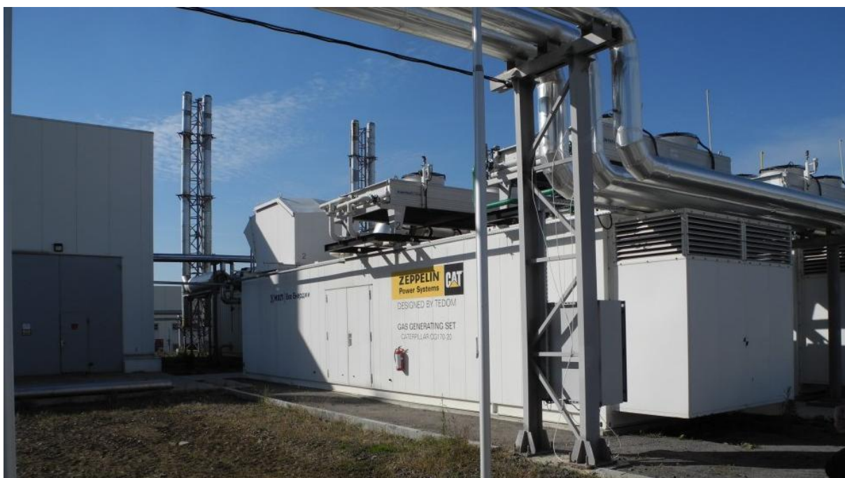
Рисунок 4.8 - . Когенераційна установка 10 МВт
