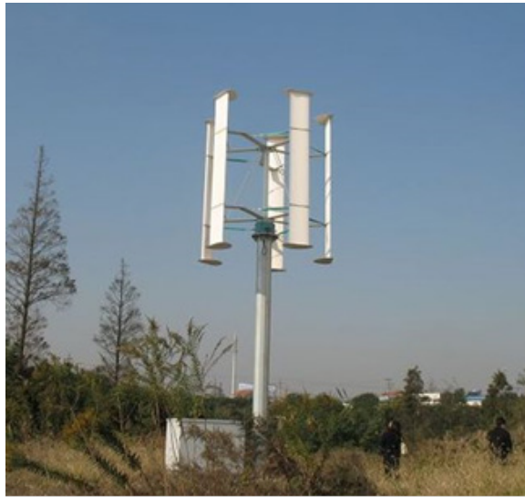
Рисунок 2.6 – Загальний вигляд електростанції 3000 W
