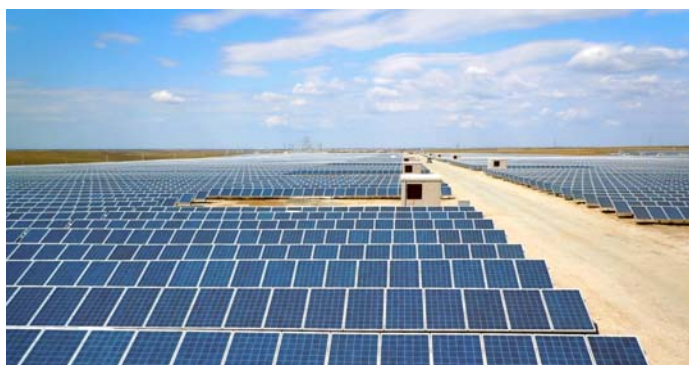
Рисунок 2.8 – Фотоелектрична сонячна станція
