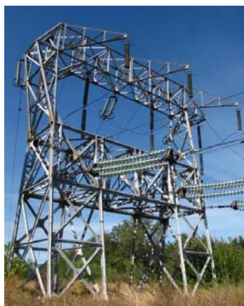
г) кінцева опора лінії 150 кВ
