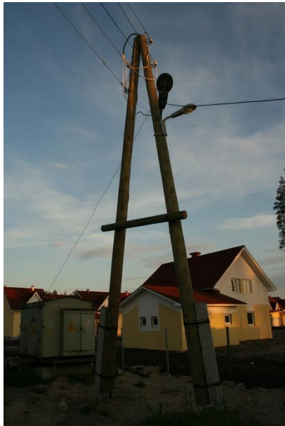
Рисунок 2.22 – Дерев'яна опора повітряної лінії 0,4 кВ
