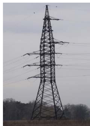
б) відпайкова опора лінії 110 кВ
