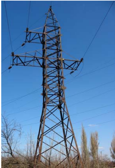
Рисунок 2.24 – Металева анкерна кутова опора повітряної лінії 35 кВ
