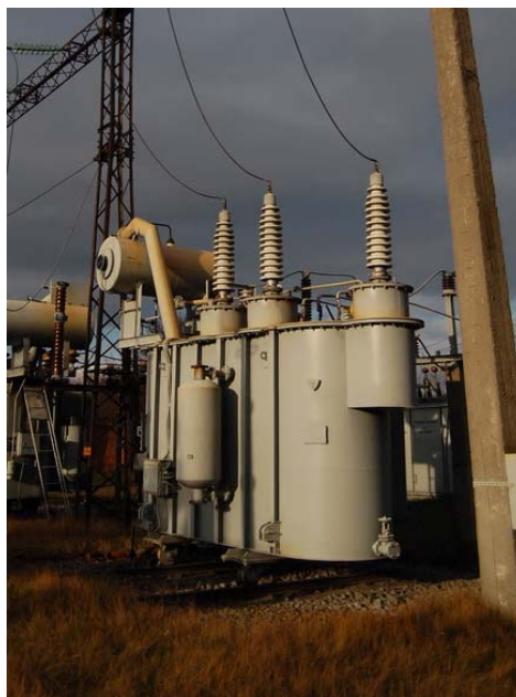
Рисунок 2.50 – Силовий трансформатор 110/10 кВ
