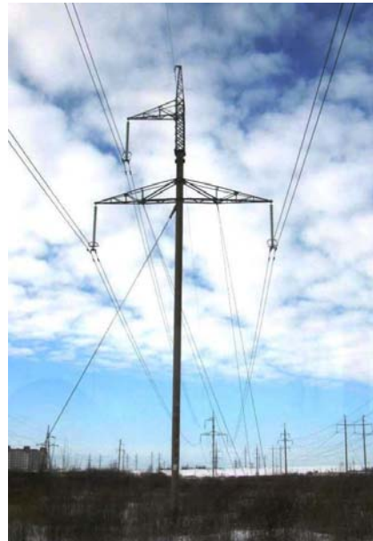
Рисунок 2.23 – Залізобетонна проміжна опора повітряної лінії 330 кВ
