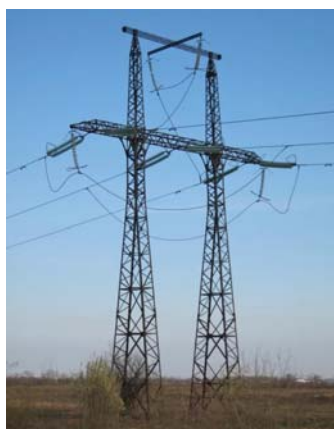
а) транспозиційна опора лінії 110 кВ
