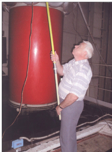
На випробуванні серійного обладнання підстанції 750 кВ. Вінниця, 2004 р.
